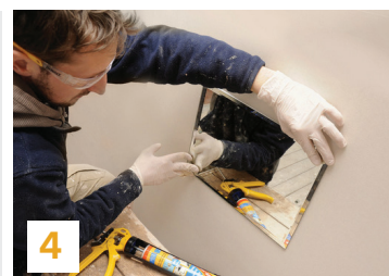
4 Vệ sinh phần keo thừa sau khi ép bằng dung dịch thích hợp
